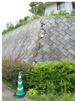
写真1 基礎部分に被害を受けた建物 (C地区)
